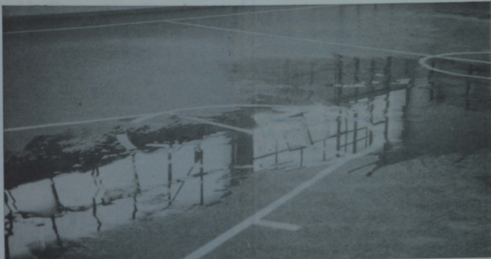
Estado del gimnasio del colegio «Príncipes de España» después de un día de lluvia.
