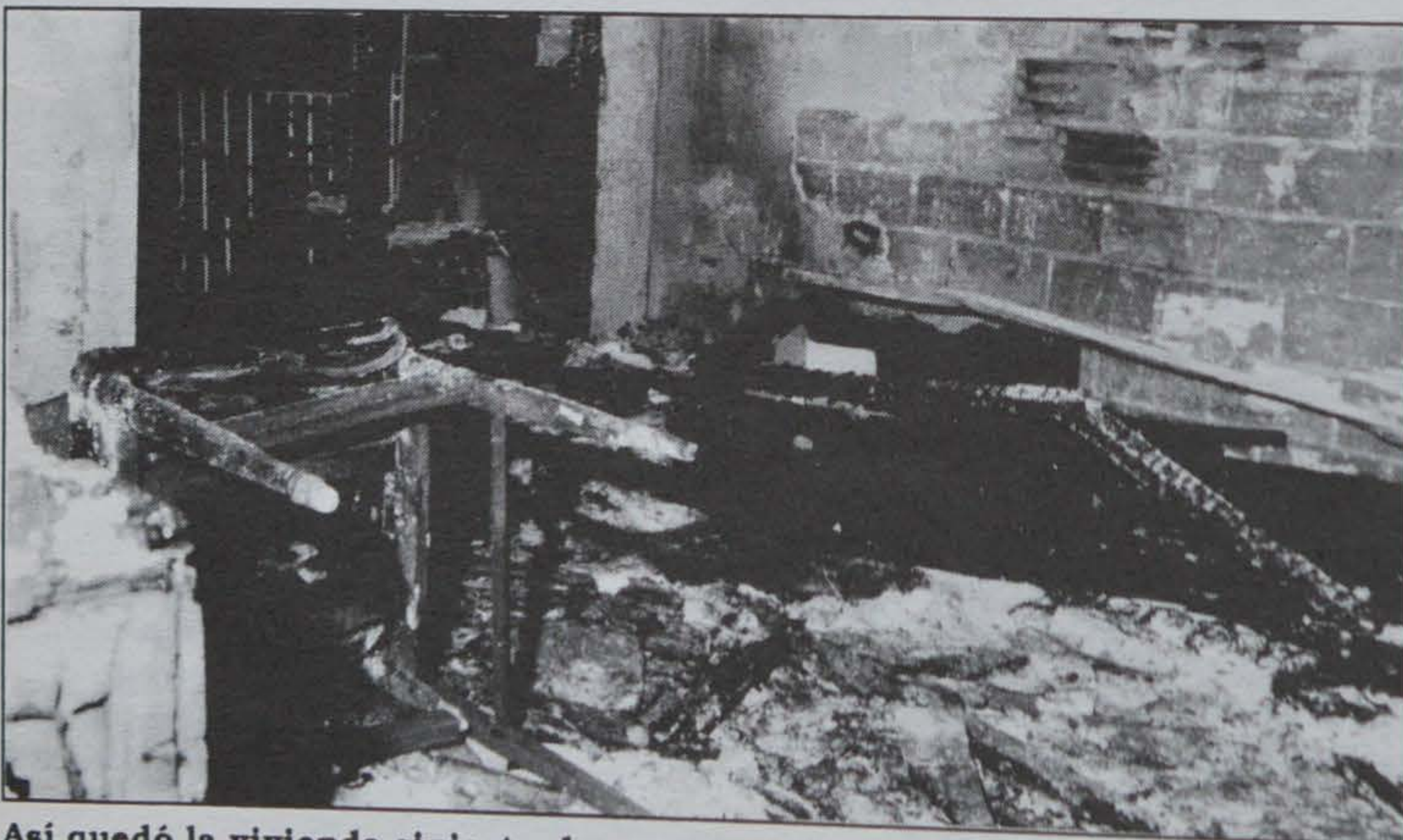
Así quedó la vivienda siniestrada
