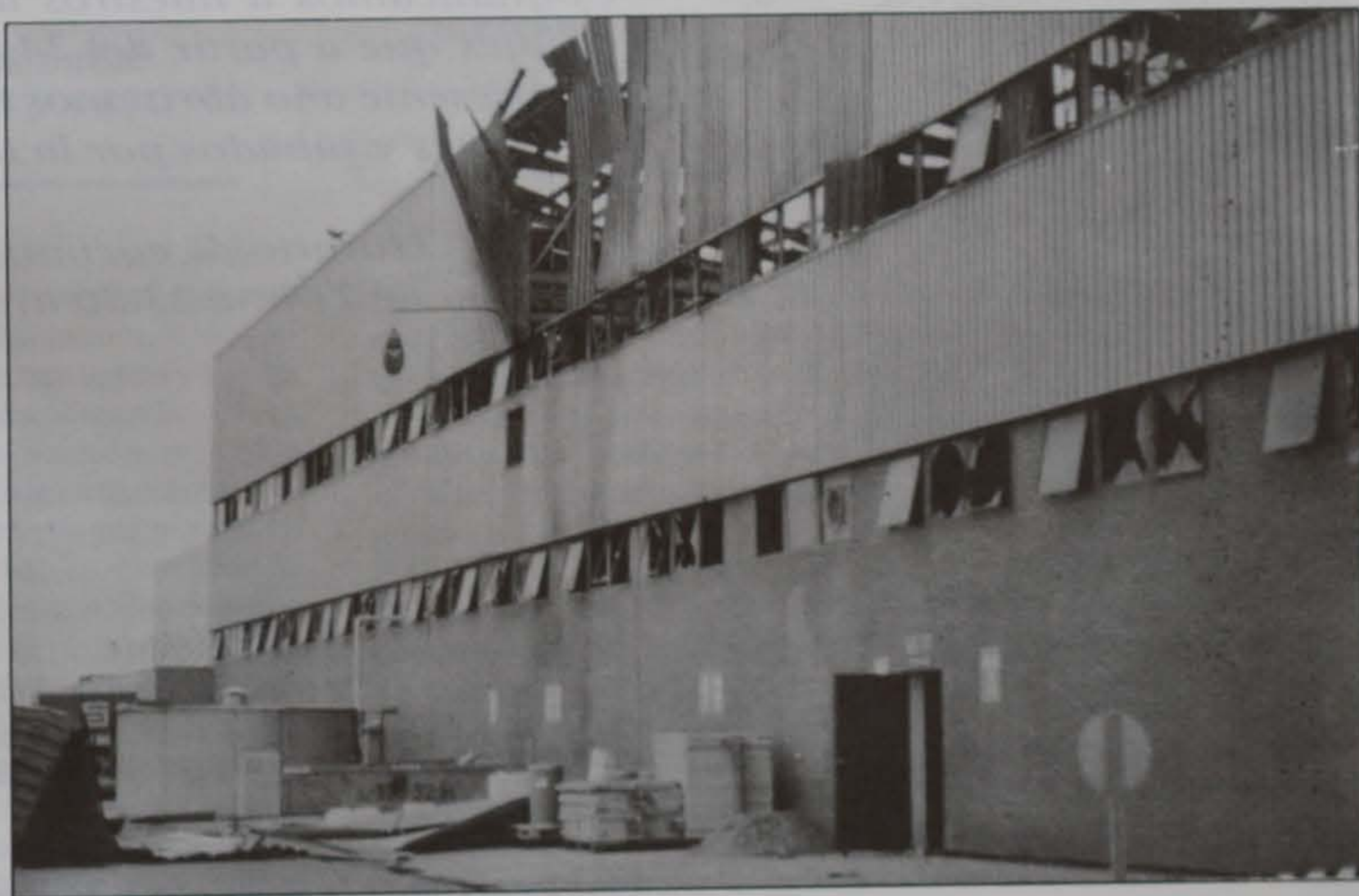
Nave destruida por la explosión
