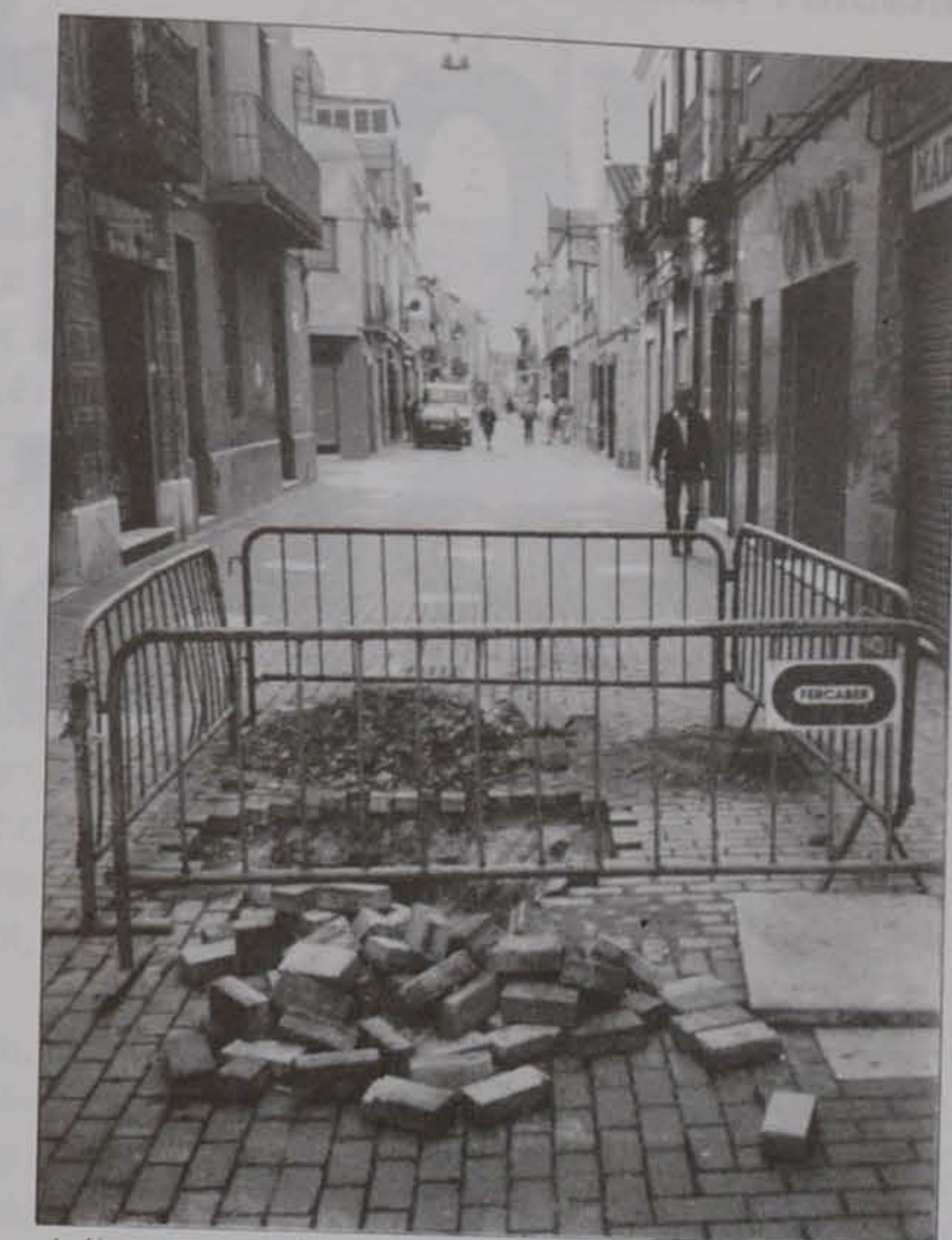
A l'esquerra, les reparacions del paviment del carrer Ferran Puig se succeeixen de forma alarmant. A la dreta, dolls d'aigua al mateix carrer: les reixes de desguàs no engolleixen
