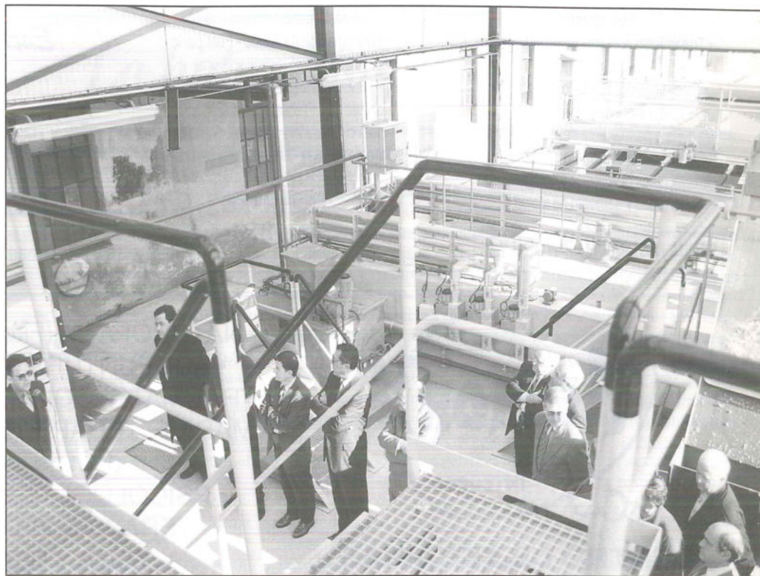
Vista de la depuradora de aguas
