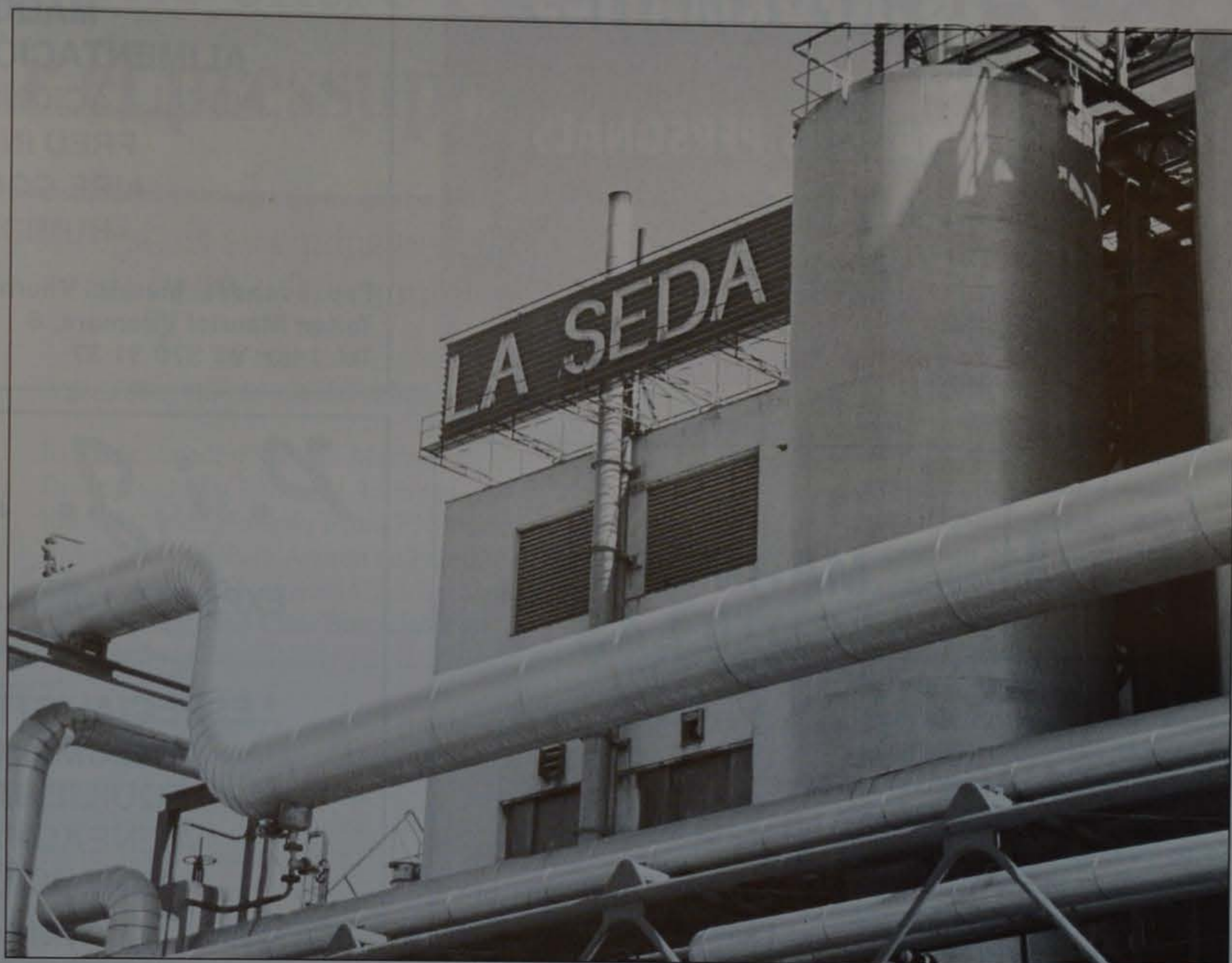
Instalaciones de la fábrica La Seda de Barcelona
