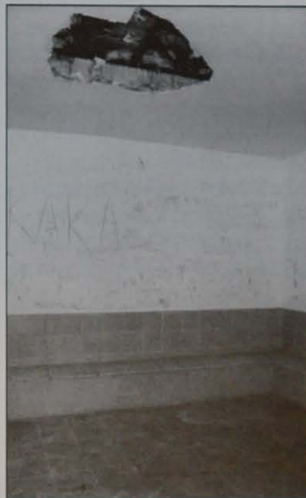
El sostre del calabós, visiblement deteriorat
