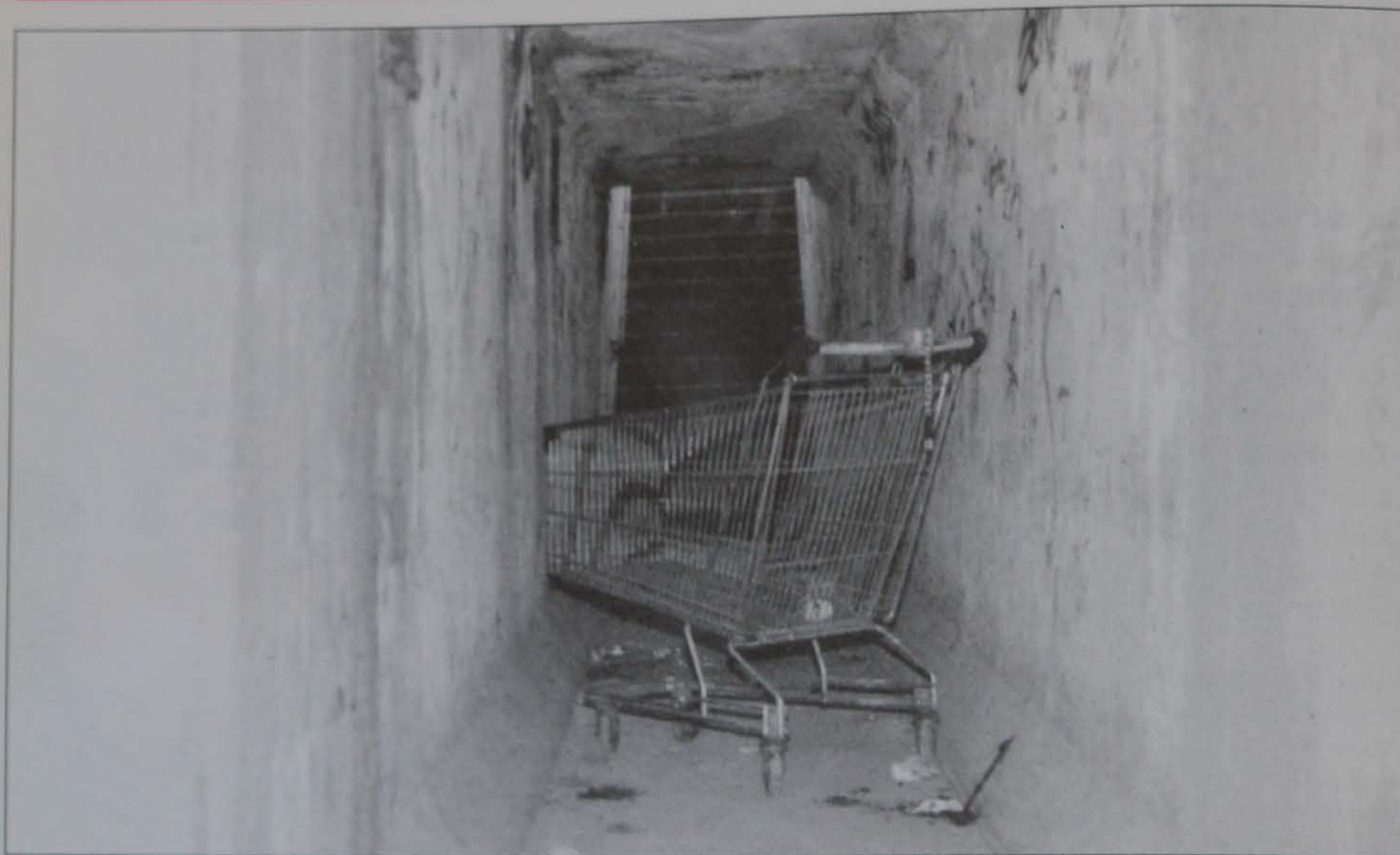
El túnel que atraviesa las vías se encuentra en un estado lamentable
