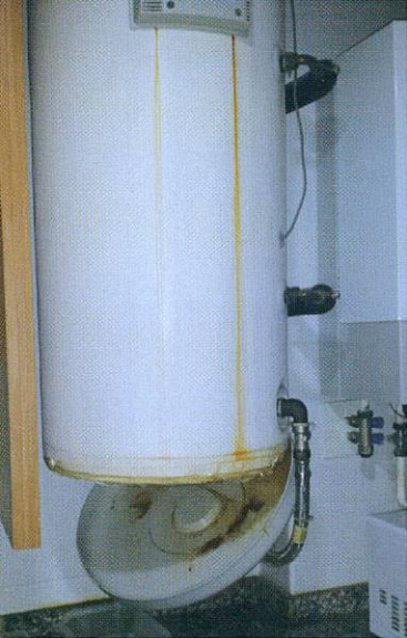
Escalfador d'aigua oxidat a causa de l'òxid de les filtracions
