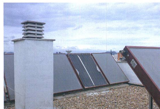
Alguns panells solars amb prou feines conserven restes de la placa exterior
