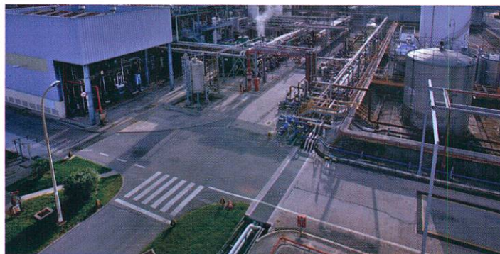
Vista parcial de la planta de Total al Prat
