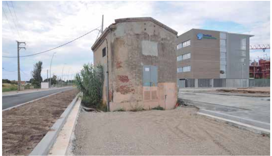
Caseta del transformador que espera el permís de Fecsa-Endesa per poder ser enderrocat / Foto: F. SERRANO
